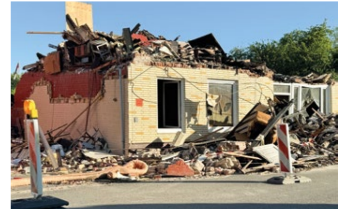
Beim letzten Brand in Kudensee wurde auch dieses Haus, welches direkt an der Dörpstraat liegt, komplett zerstört.
